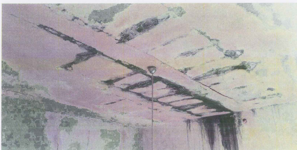
Fig. 5/6/7 – Fenomeni di degrado statico della struttura.
